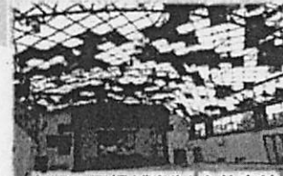
台風で屋根が消失した体育館
